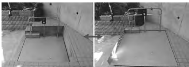
段差解消機が降りた状況 段差解消機が上がった状況
